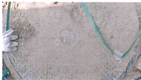
项目内的雨水井
